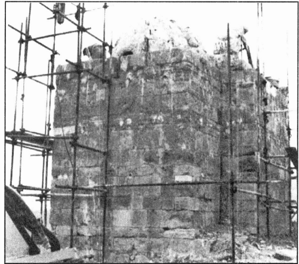
تصویر شماره ۵۹ - نمای خارجی ضلع شرقی کلیسا در حال اتمام دیوارهای بدنه و احداث نیم گنبد طاقمهای محراب و قوس طاقمهای جانبی.
